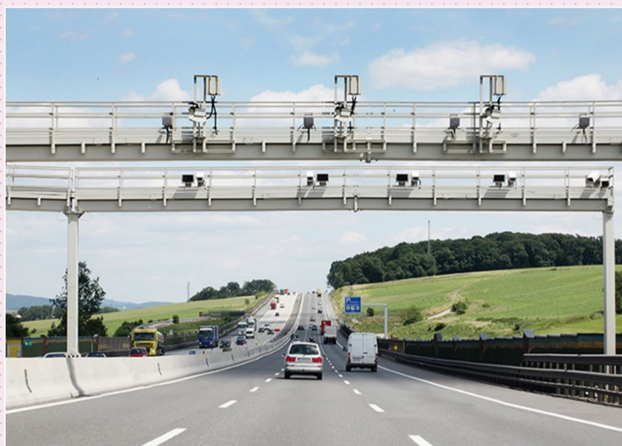
Slika 1: Cestninski portal z nameščeno opremo DSRC cestninjenja Vir: Asfinaq, 2017
